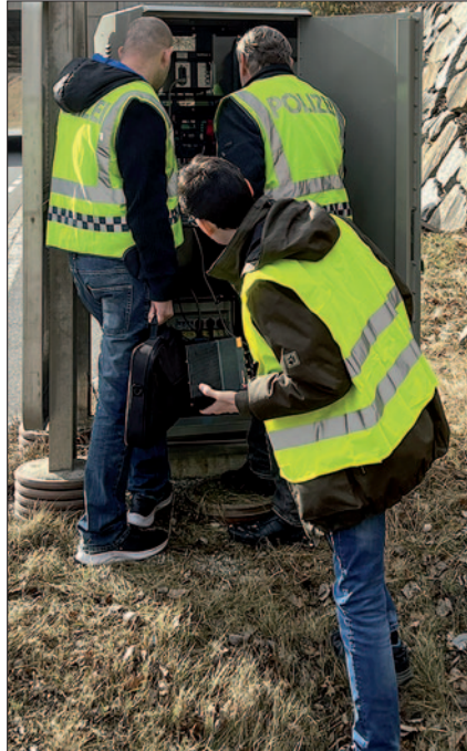
Fernauslesung von Radarboxen: Zwei Drittel der stationären Radargeräte werden umgerüstet
