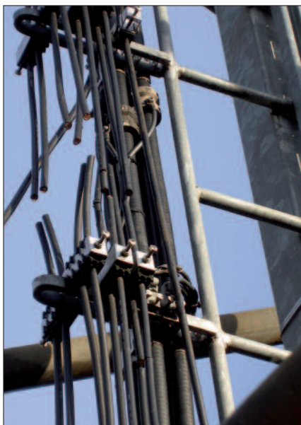
Sabotage: durchtrennte Datenkabel bei Mobilfunksendemasten.
