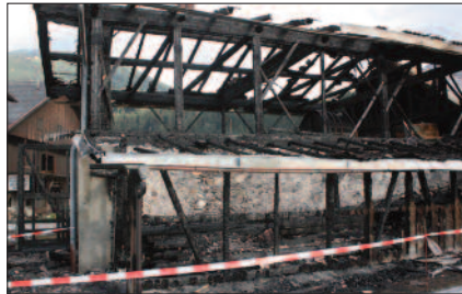
Fallanalyse: Unterstützung bei der Aufklärung von Brandanschlägen in Kasernen und Wirtschaftsgebäuden in Tirol.
