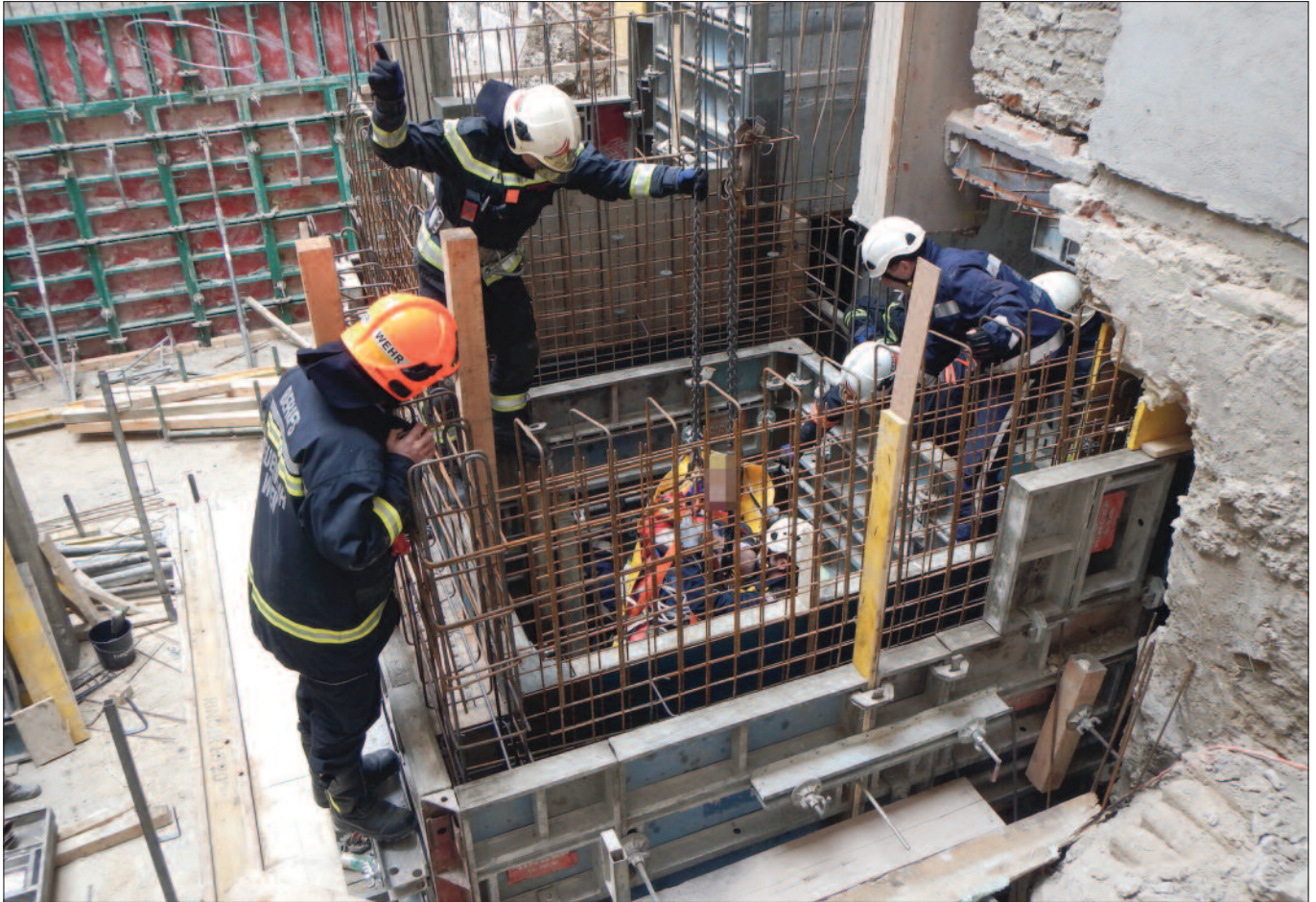
Unfall auf einer Baustelle: Höhenretter der Wiener Berufsfeuerwehr im Einsatz.
