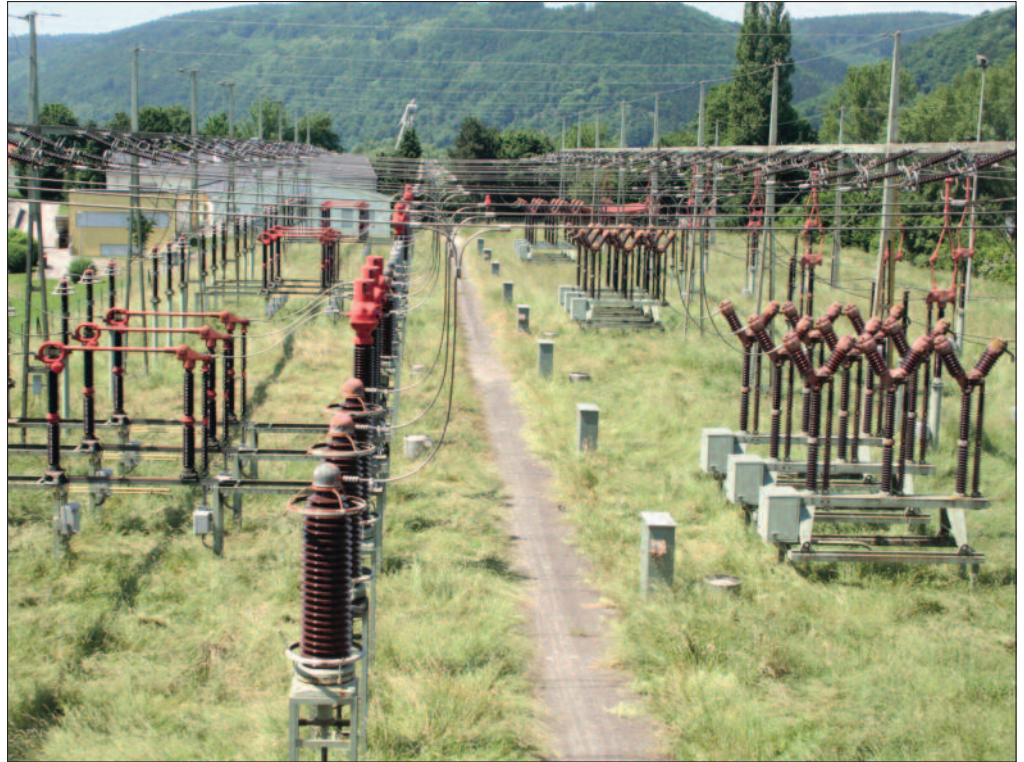
Stromversorgung: „Die Netze werden zunehmend an der Belastungsgrenze betrieben.“
