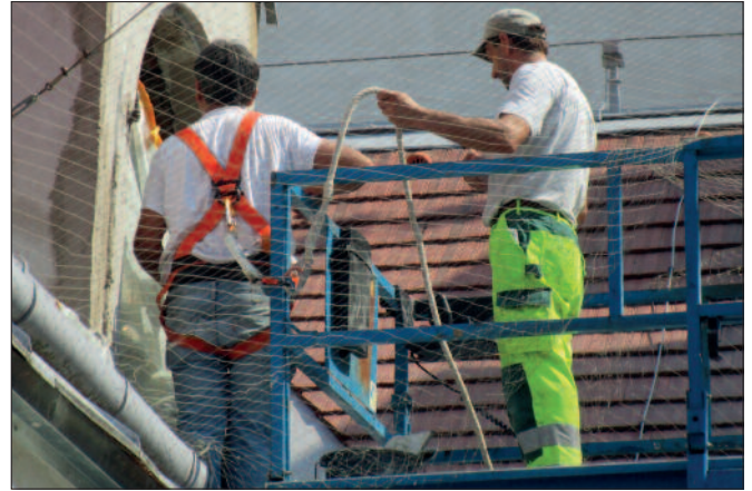
Unfälle am Arbeitsplatz verhindern: Seil-/Gurtsicherung bei Höhenarbeiten.
