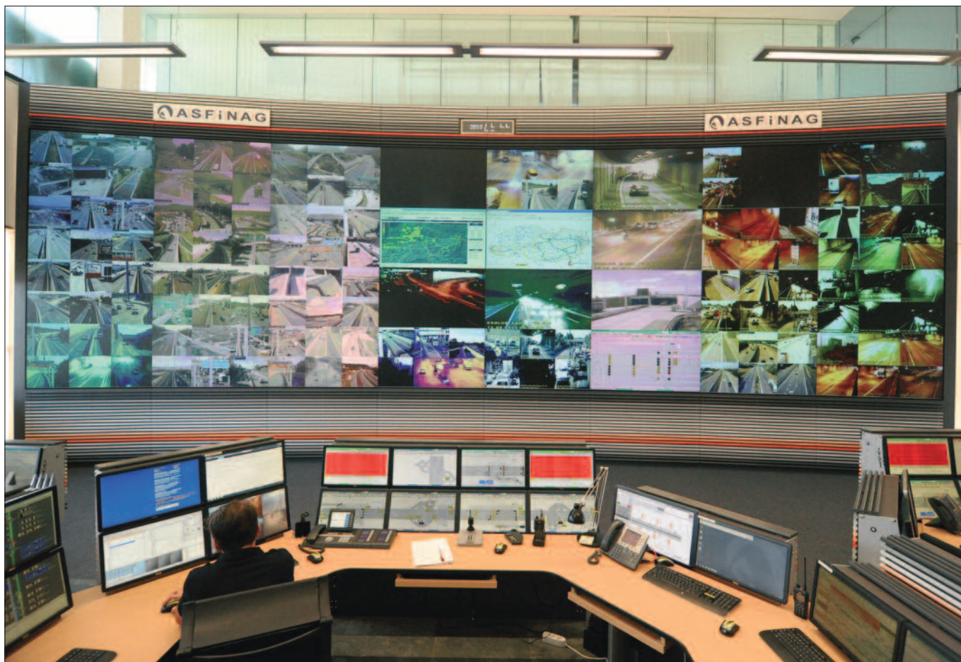
Verkehrsmanagementzentrale der ASFINAG in Wien-Inzersdorf: Informationen sammeln, aufbereiten und verteilen.
