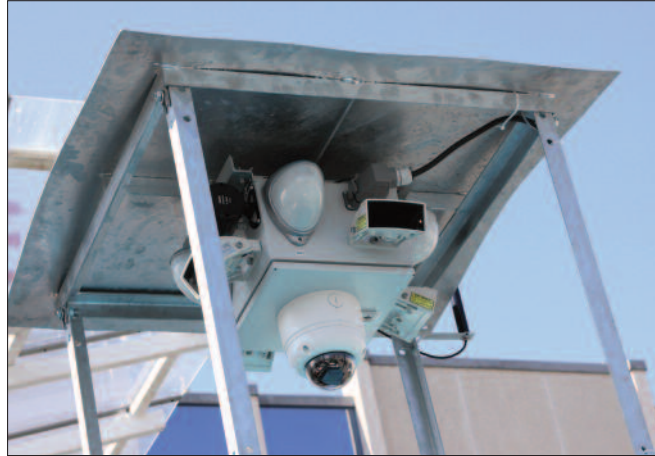
Mobiler Überwachungscontainer: Die Videoüberwachungsanlage wird mit Solarenergie betrieben.
