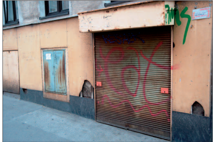
Phänomene von Unordnung (Vandalismus, Verschmutzung) beeinträchtigen das Sicherheitsgefühl.
