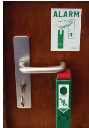
Fluchtwegsicherung: Das Alarmierungsgerät ist unter dem Türdrücker.
