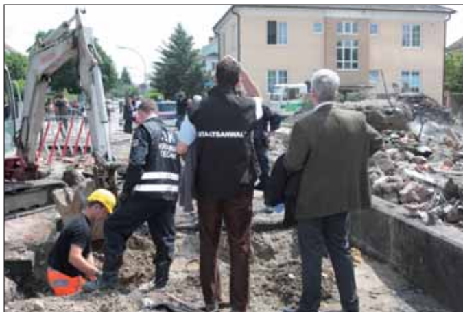
Einsturz eines Hauses nach einer Explosion in Niederösterreich: Kriminaltechniker ermittelten die Ursache.
