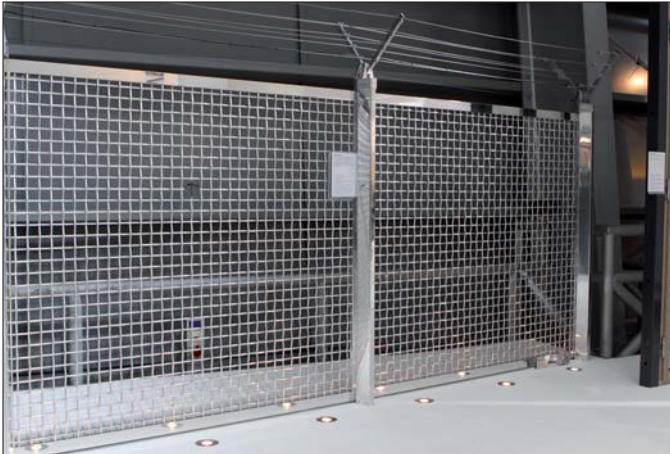
Wavegard-Zaun mit Sensordrähnen: Das System meldet Eindring- und Übersteigerversuche.
