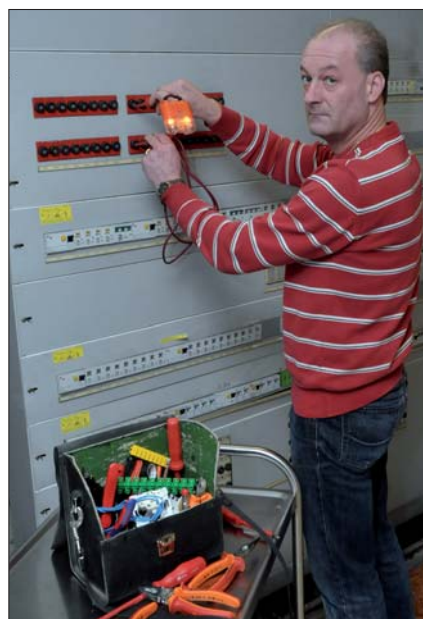
Hauselektriker: Unter anderem für die Wartung und Betreuung der Heizungs-, Klima- und Lüftungsanlagen zuständig.
