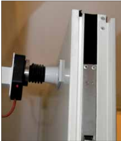
Brandschutztür im Innenministerium: Wird bei Brandalarm geschlossen.
