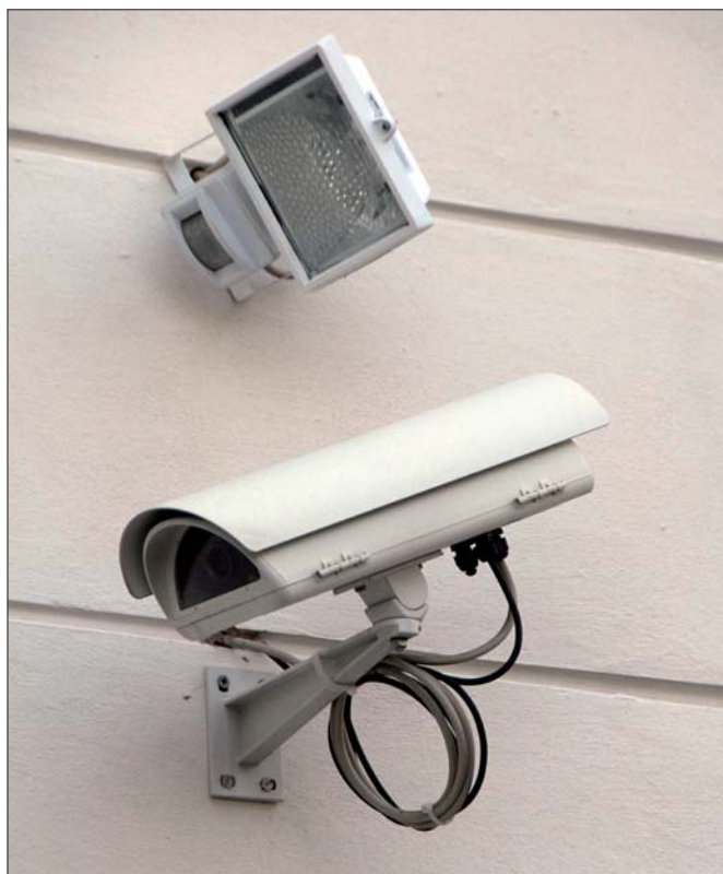
Videoüberwachung erfordert begleitende Sicherheitsmaßnahmen, etwa eine Beleuchtung der überwachten Bereiche.
