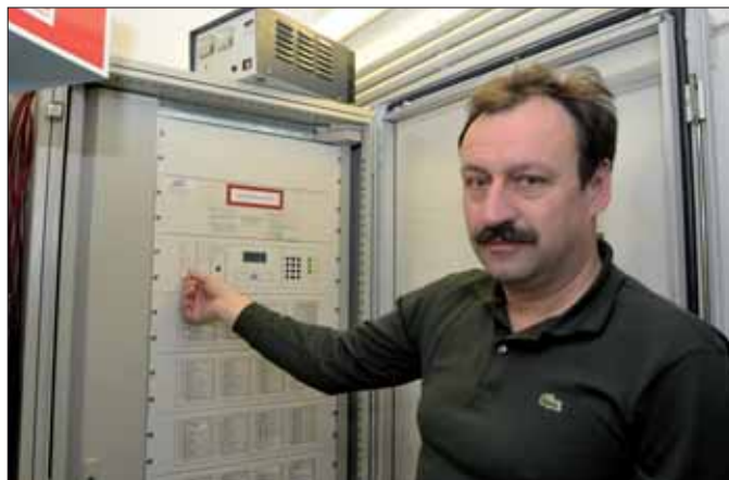
Brandmeldezentrale: Der Brandschutzbeauftragte sieht nach, in welchem Raum der Brandalarm ausgelöst worden ist.
