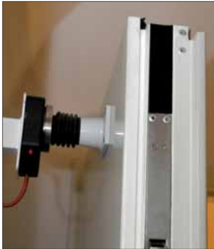
Brandschutztür im Innenministerium: Wird bei Brandalarm geschlossen.
